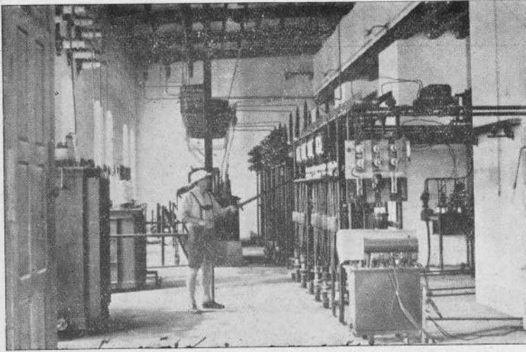
اطاق ترانسفارمرهای فابریکه برق جبل السراج
