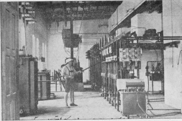
اطاق ترانسفارمهای فابریکه برق جبل السراج
