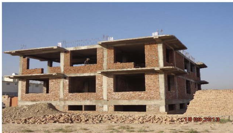
تصویری از ادامه کار مطابق نقشه های انجینری ساختمان (موقعیت پروژه - شهر کابل)
