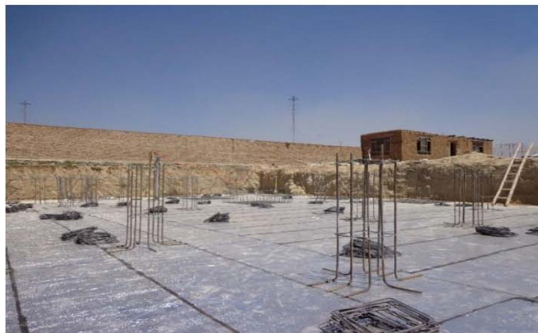
تصویری از نصب پایه های تهداب ها برای تهکوی مطابق نقشه های انجینری ساختمان (موقعیت پروژه - شهر کابل)
