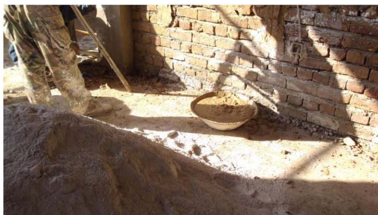
نمای قسمت تعمیر رهائشی واقع خیر خانه ( کابل ) گاه گل بعداً سینگل برای تمام دیوارهای داخلی
