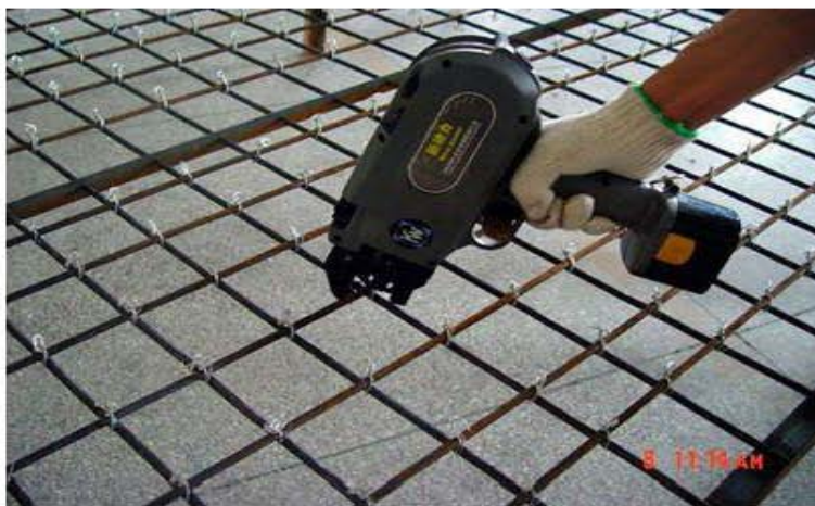
تصویری از ماشین سیمتاری برای سیخبندی پوشش مطابق نقشه های انجینری ساختمان (موقعیت پروژه - شهر کابل)
