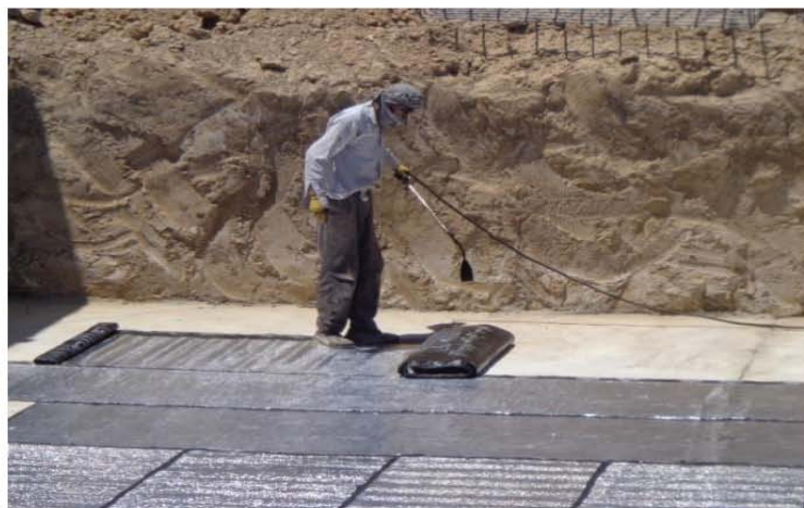
تصویری از عایق کاری ساحه برای تهکوی مطابق نقشه های انجینری ساختمان (موقعیت پروژه - شهر کابل)
