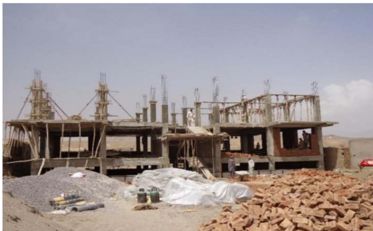
تصویری از کانکری ریزی پایه ها مطابق نقشه های انجینری ساختمان (موقعیت پروژه - شهر کابل)
