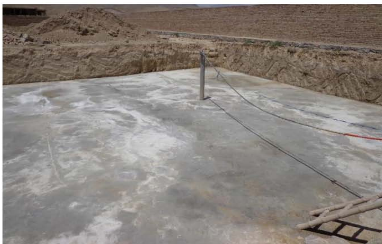
تصویری از کانکریت ریزی بدون سیخ ( PCC ) ساحه برای تهکوی مطابق نقشه های انجینیری ساختمان (موقعیت پروژه - شهر کابل)
