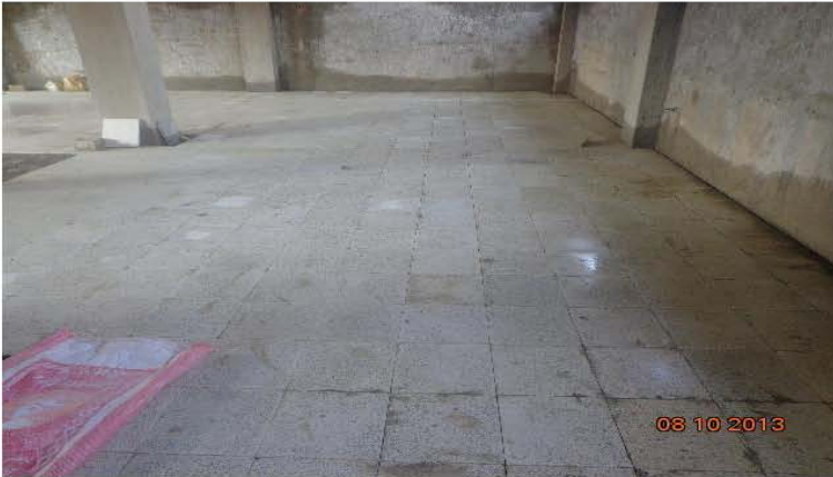
تصویری از نصب سنگ تراسو در فرش ها مطابق نقشه های مهندسی (موقعیت پروژه - شهر کابل)
