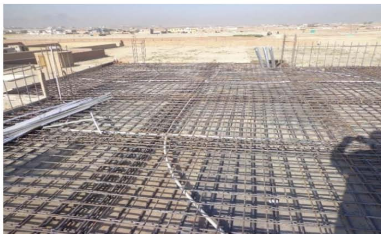
تصویری از پایپ دوانی برای برق داخلی سقف (چت) مطابق نقشه های انجینری ساختمان (موقعیت پروژه - شهر کابل)
