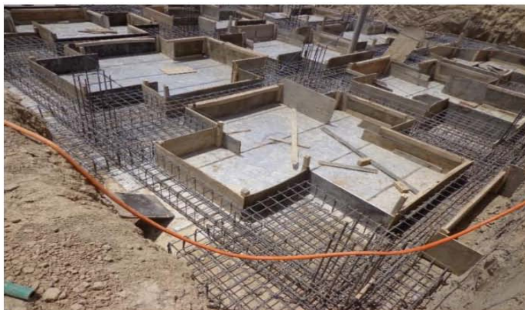
تصویری از قالب بندی برای تهداب ها برای تهکوی مطابق نقشه های انجینری ساختمان (موقعیت پروژه - شهر کابل)
