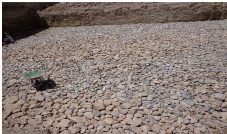
تصویری از جغل فرش و کمپکشن ساحه برای تهکوی مطابق نقشه های انجینیری ساختمان (موقعیت پروژه - شهر کابل)
