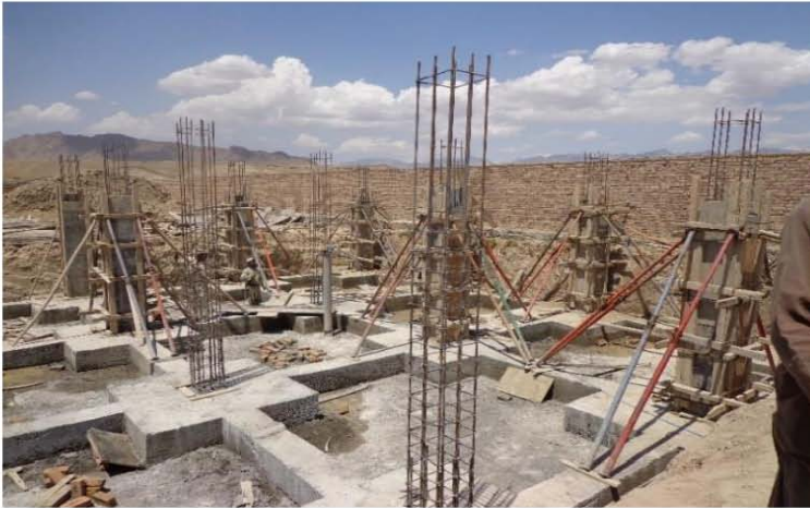
تصویری از آماده گی برای کانکریت ریزی برای پایه ها مطابق نقشه های انجینری ساختمان (موقعیت پروژه - شهر کابل)
