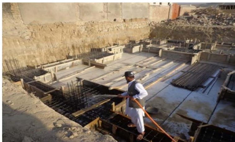
تصویری از پاک کاری قالب بندی برای تهداب ها برای تهکوی مطابق نقشه های انجینری ساختمان (موقعیت پروژه - شهر کابل)
