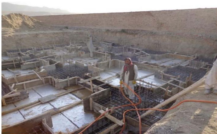
تصویری از پاک کاری قالب بندی برای تهداب ها برای تهکوی مطابق نقشه های انجینری ساختمان (موقعیت پروژه - شهر کابل)
