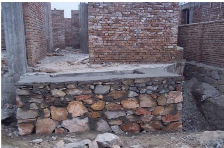
نمای تعمیر رهایشی واقع کارته پروان ( کابل )
