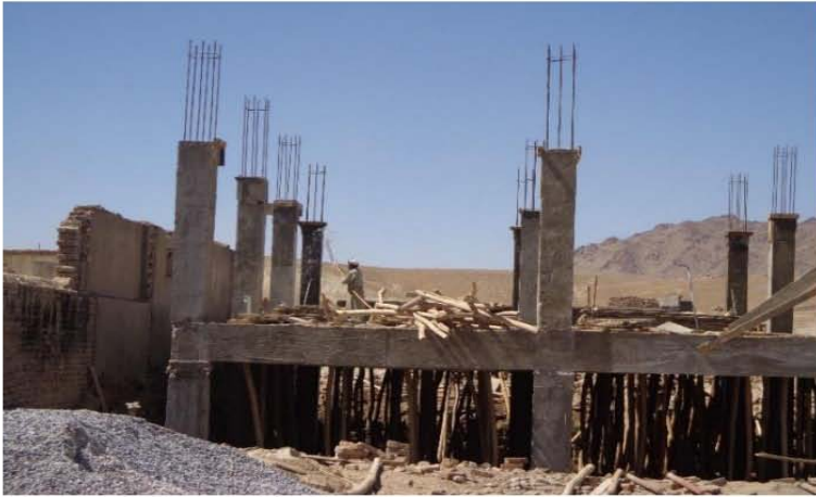
تصویری از آماده گی برای قالب بندی پوشش مطابق نقشه های انجینری ساختمان (موقعیت پروژه - شهر کابل)
