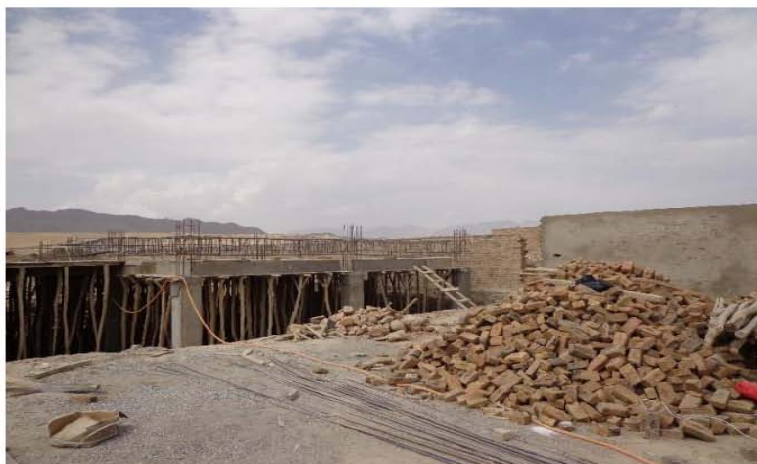
تصویری از آماده گی برای خشت کاری دیوار ها مطابق نقشه های انجینری ساختمان (موقعیت پروژه - شهر کابل)
