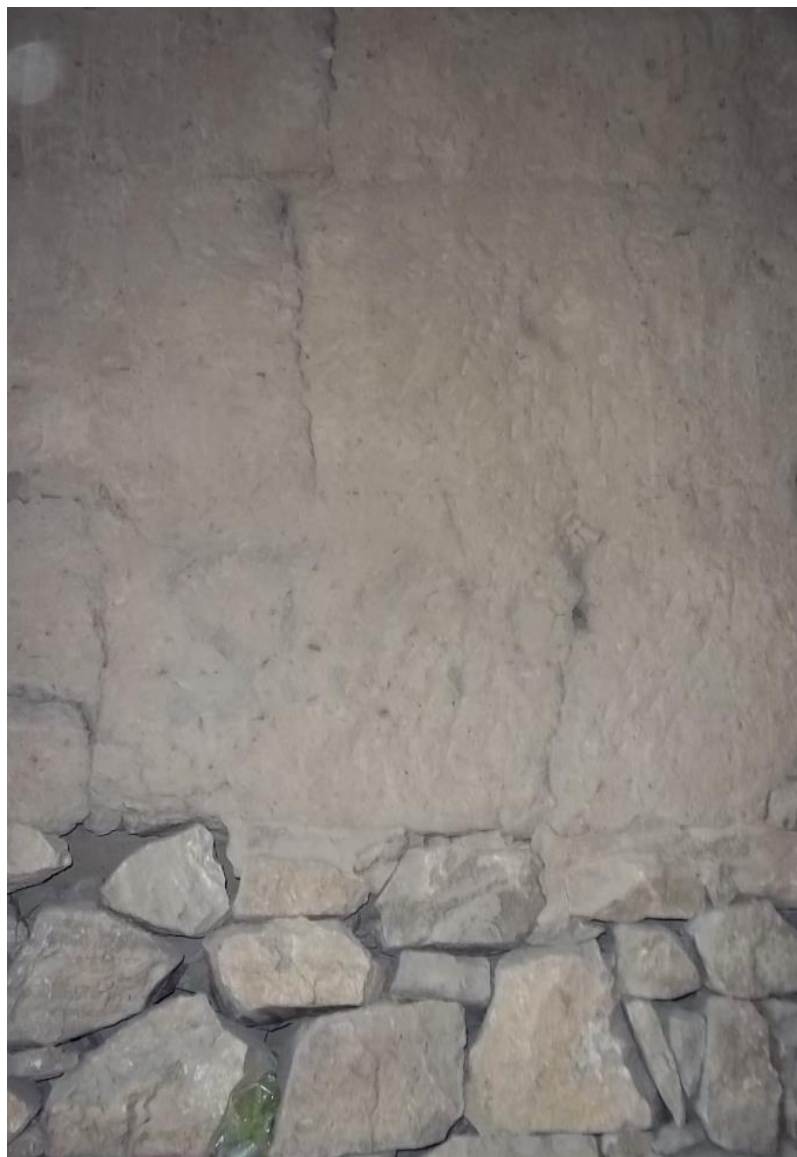
عکس از دیوار خارجی یکی از خانه ها
