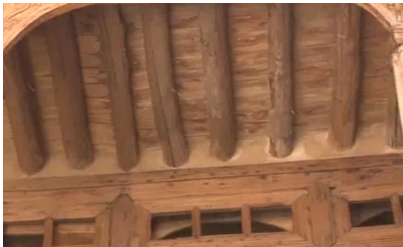
عکس از سقف اتاق بدون مسطح
