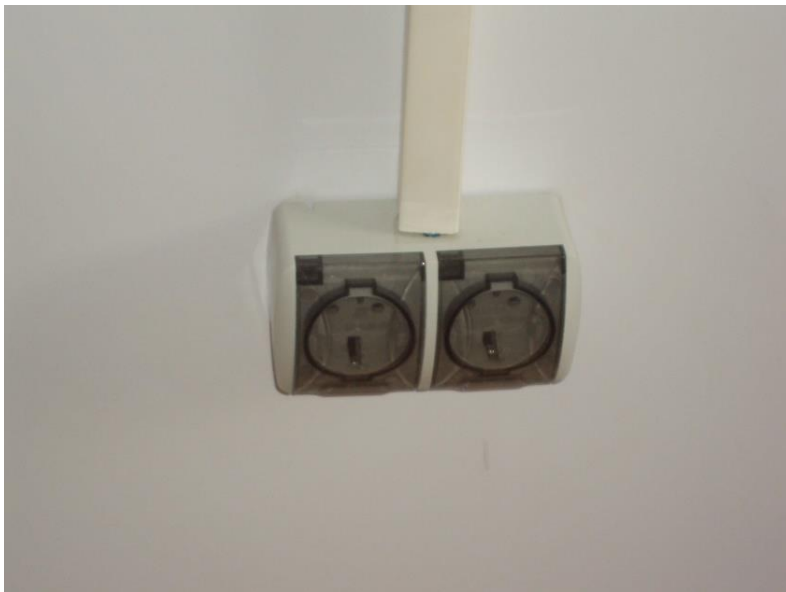
تصویر انتریر (نصب ساکت) کانتینر های تی آی ام
