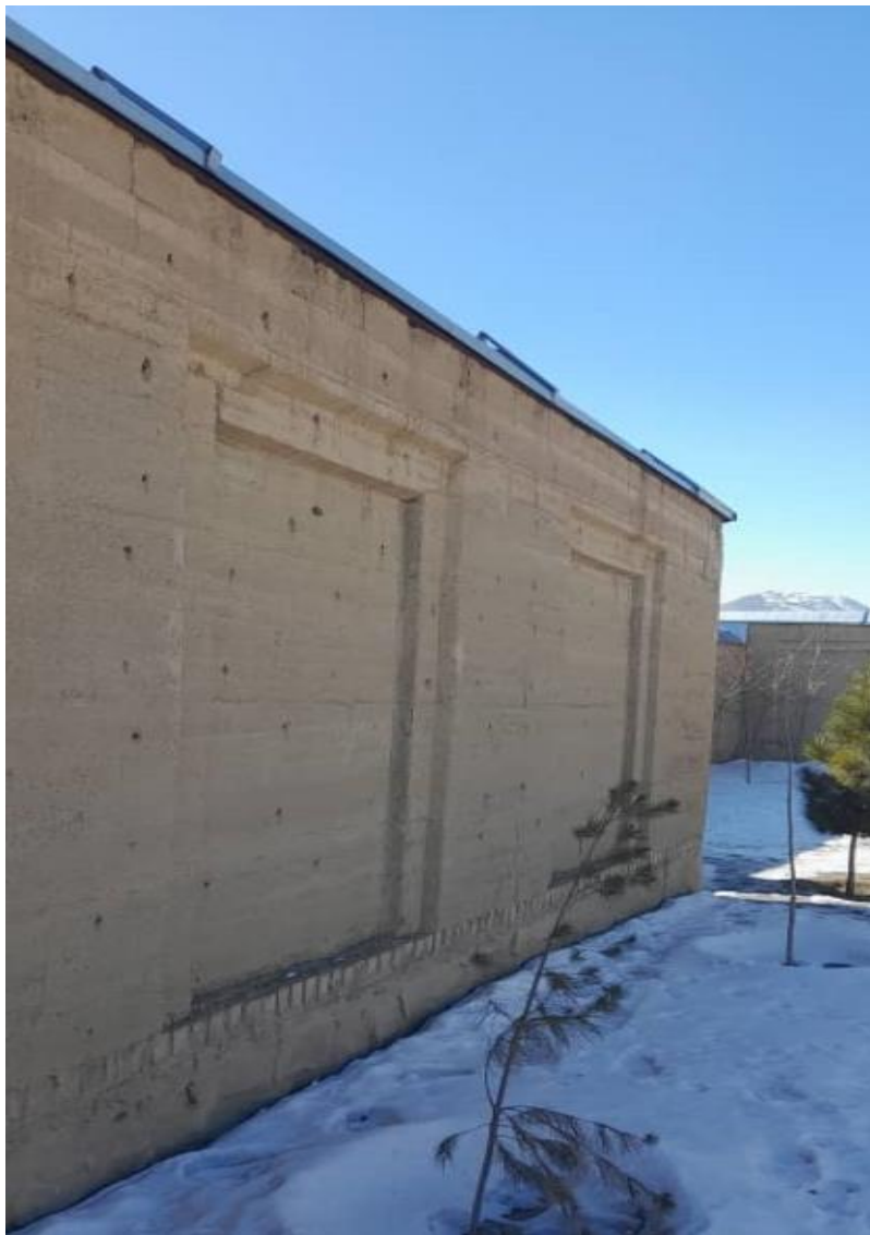
تصویری از دیوار احاطه قسمت سمت جنوب
