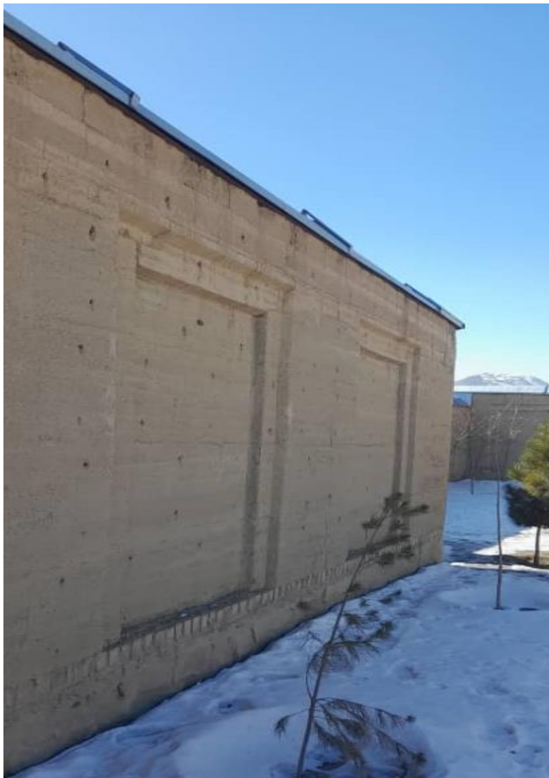
تصویری از دیوار احاطه قسمت سمت جنوب
