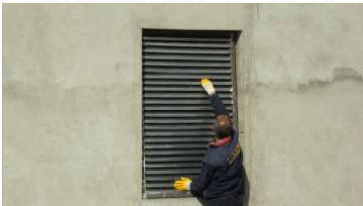
تصویری از هواکش (Louver) جنراتور خانه
