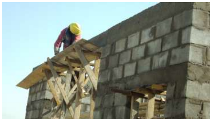
تصویری از ساختمان جنراتور خانه
