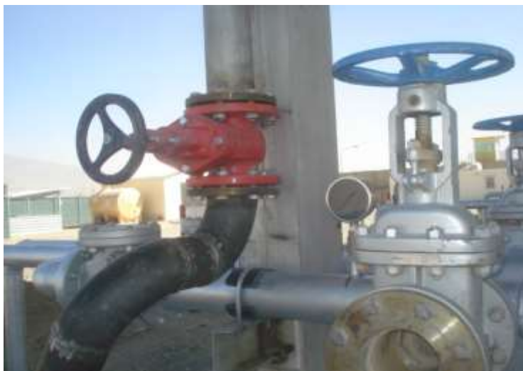
تصویری از بخش اطفایه در ساحه
