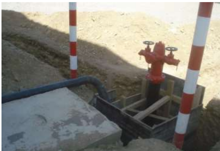
تصویری از بخش اطفایه در ساحه
