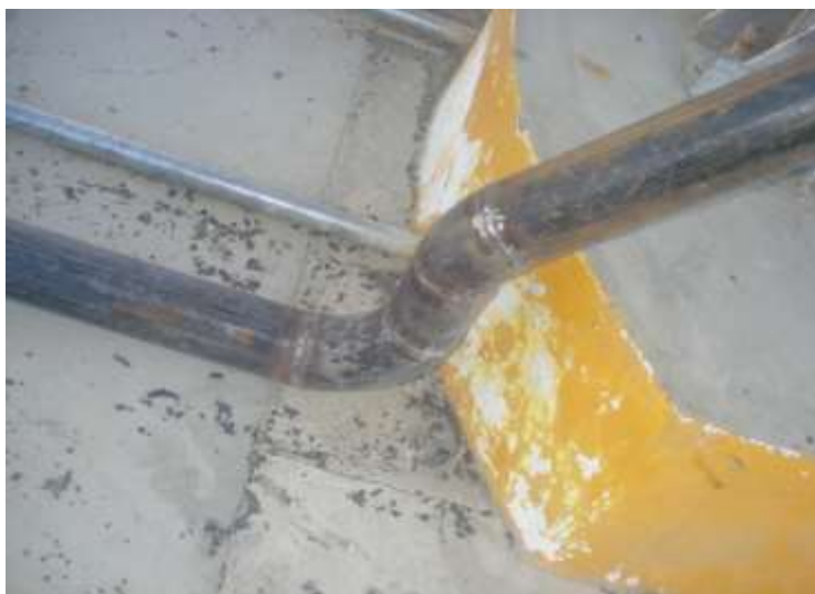
تصویری از بخش اطفایه در ساحه
