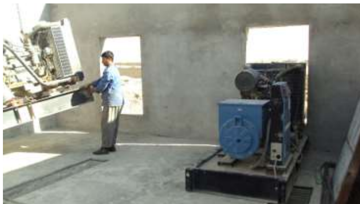
تصویری از ساختمان جنراتور خانه و جابجایی جنراتورها
