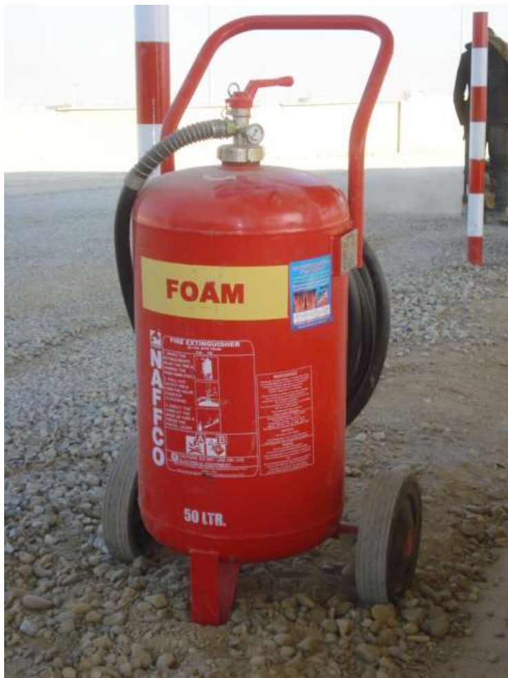
تصویری از بخش اطفایه در ساحه
