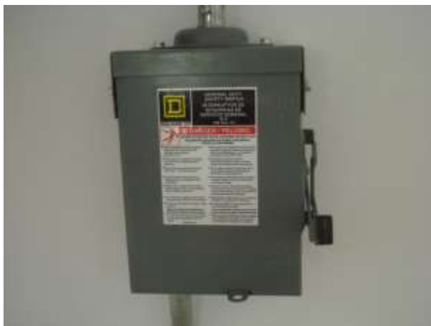
تصویری از تبدیل کننده سیستم برق کانکس (کانتینر)
