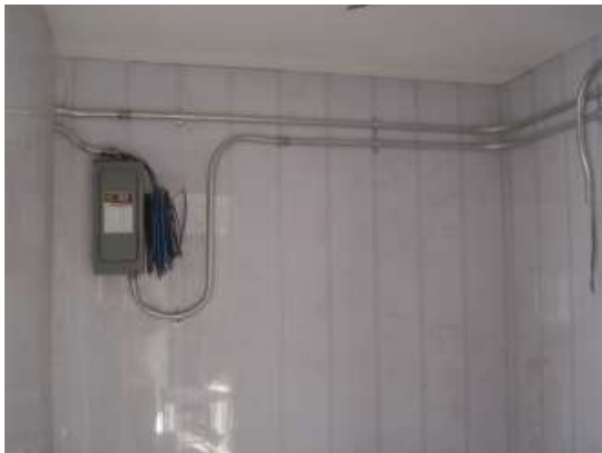
تصویری از سیستم برق تشناب کانتینر
