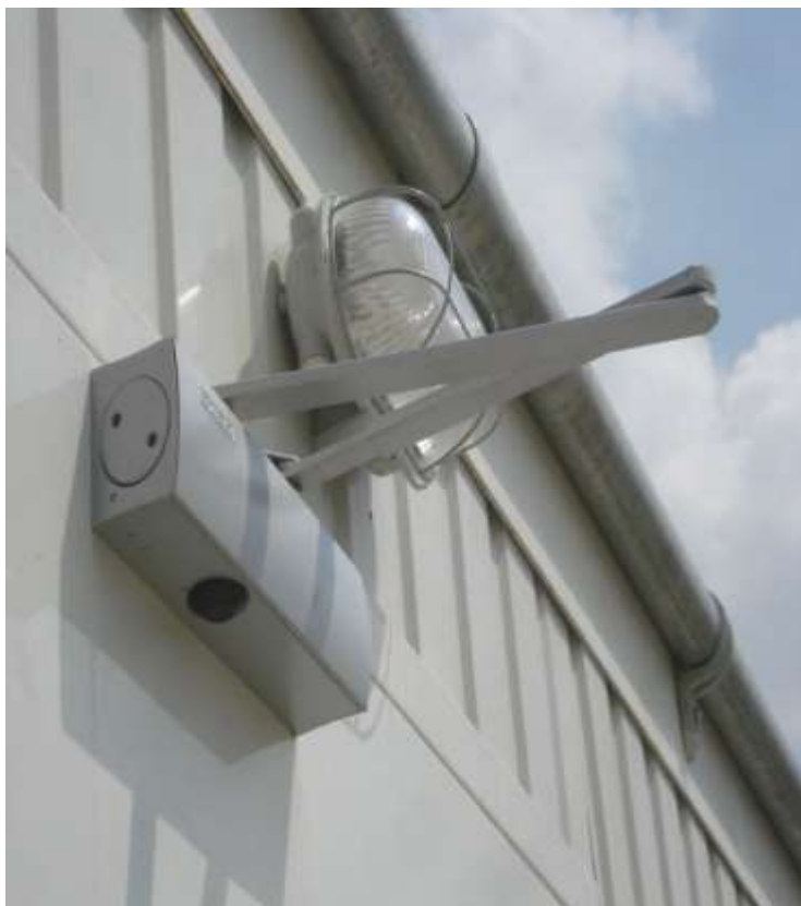
تصویری از قسمت دروازه خارجی (کانتینر)
