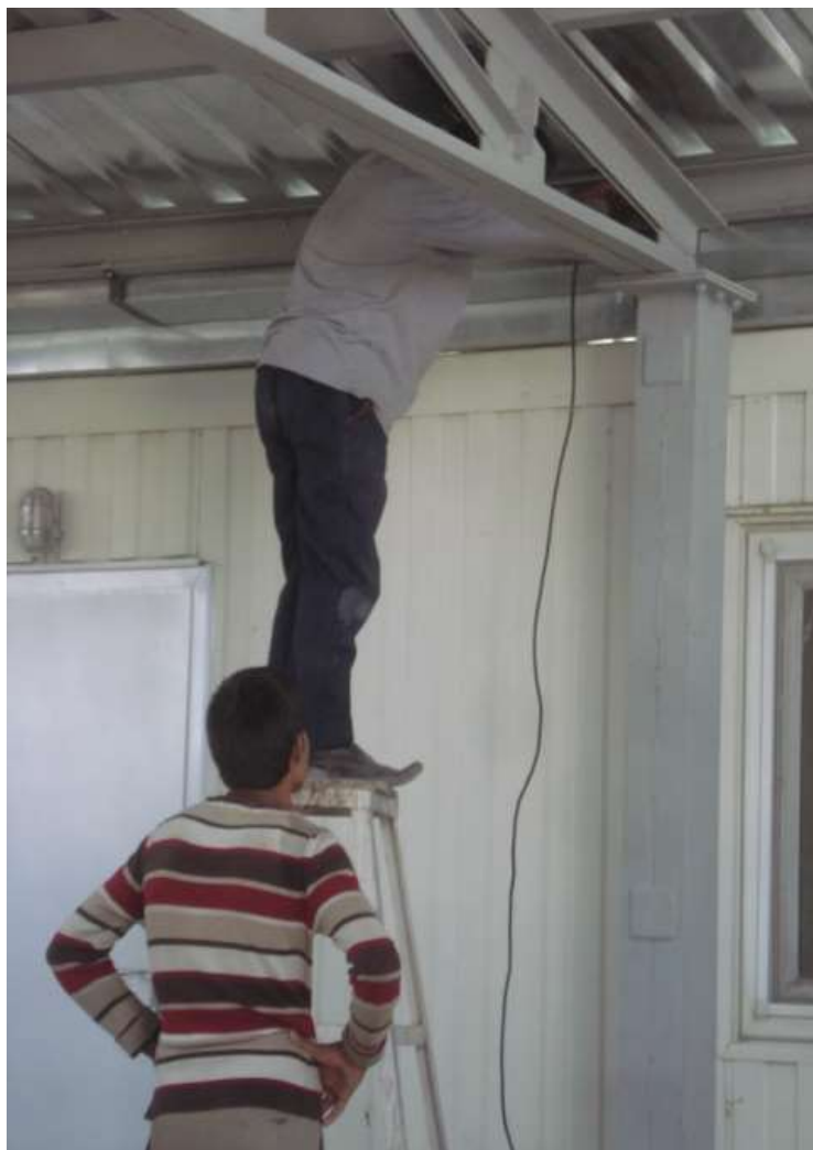
تصویری از اتصال برق هواکش ورکشاپ
