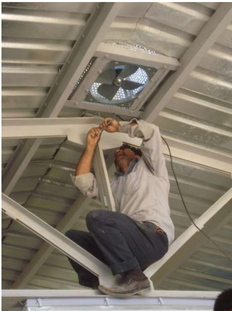
تصویری از اتصال برق هواکش ورکشاپ
