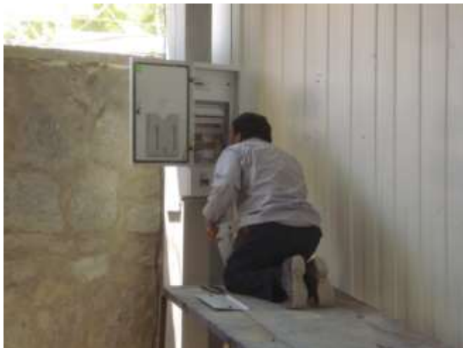
تصویری از اتصال برق ورکشاپ
