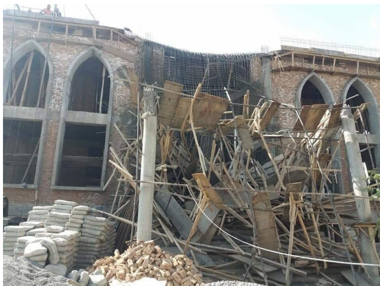
فروریزی قسمتی از مسجد شریف در اثنای کانکریت ریزی که باعث کشته شدن یکنفر و زخمی شدن ۴ نفر گردید ( مسجد الجهاد شهر غزنی )
