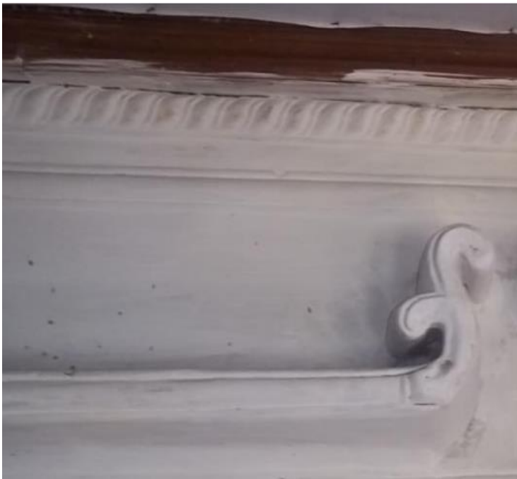
تصویری از رپک دیوار های خانه
