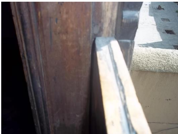
تصویری یکی از قسمت های با لایی پله ها که دارای جری یا فرورفتگی در قسمت وسطی آن میباشد
