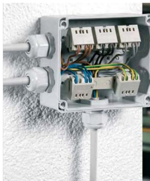
ب) گلند در محل ورود تابلوی برق
