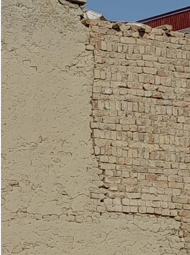
تصویری از عدم موجودیت تدابیر دفاعی برای تهداب ها، درز ها و استفاده مواد نادرست ساختمانی به اساس وزن
