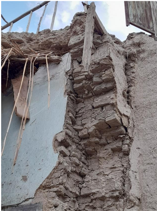
نمونه استفاده مصالح نا درست ساختمان در دیوار ها و پوشش ها
