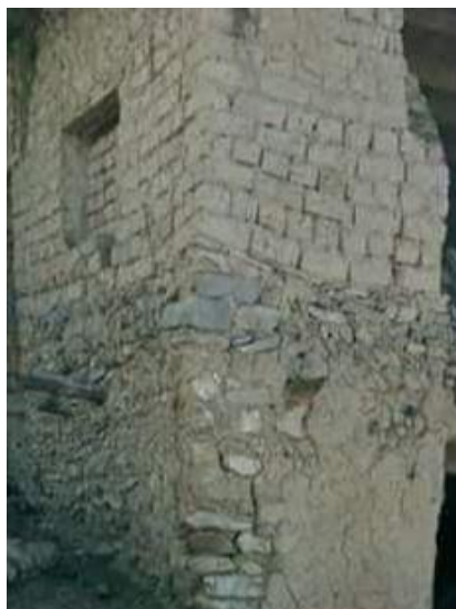
تصویری یکی از دیوار ساختمان در مناطق زلزله زده اخیر پکتیکا
