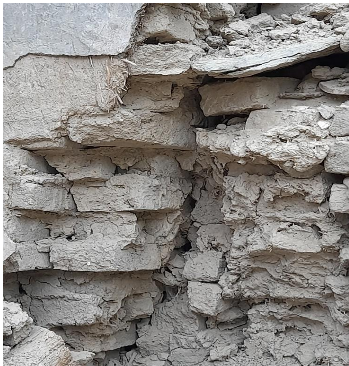
تصویری از عدم رعایت درز ها و یا جینت های ساختمانی
