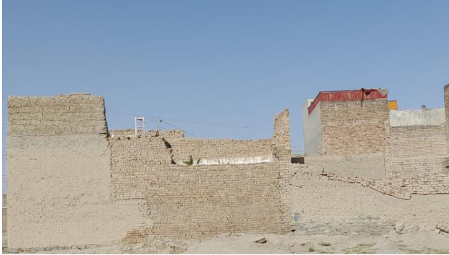
تصویری از عدم موجودیت تدابیر دفاعی برای تهداب هاواستفاده مواد نادرست ساختمانی به اساس وزن
