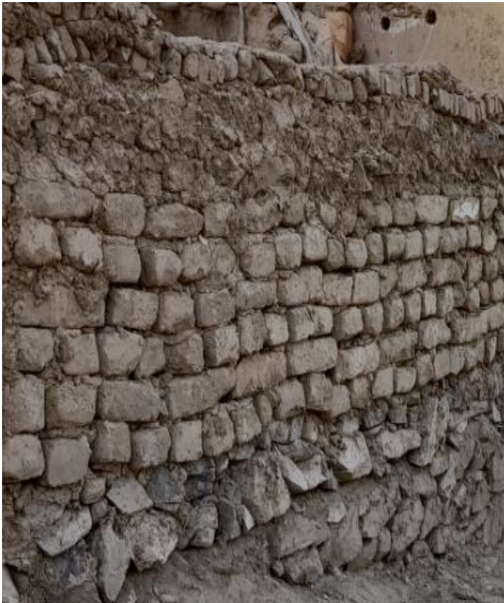
تصویری از عدم رعایت اصول دیوار سازی
