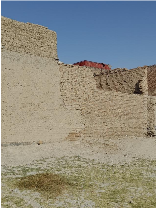
تصویری از عدم موجودیت تدابیر دفاعی برای تهداب هاواستفاده مواد نادرست ساختمانی به اساس وزن
