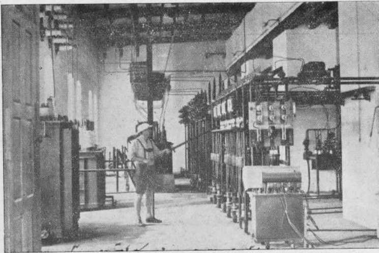
اطاق ترانسفارمهای فابریکه برق جبل السراج
