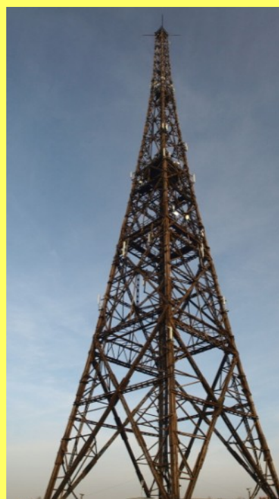
فرستنده ی ایستگاه گایویتس
