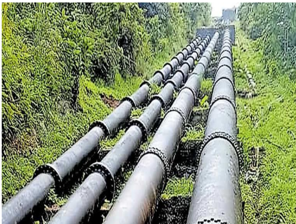
انځور: فشاري نل (Penstock)
