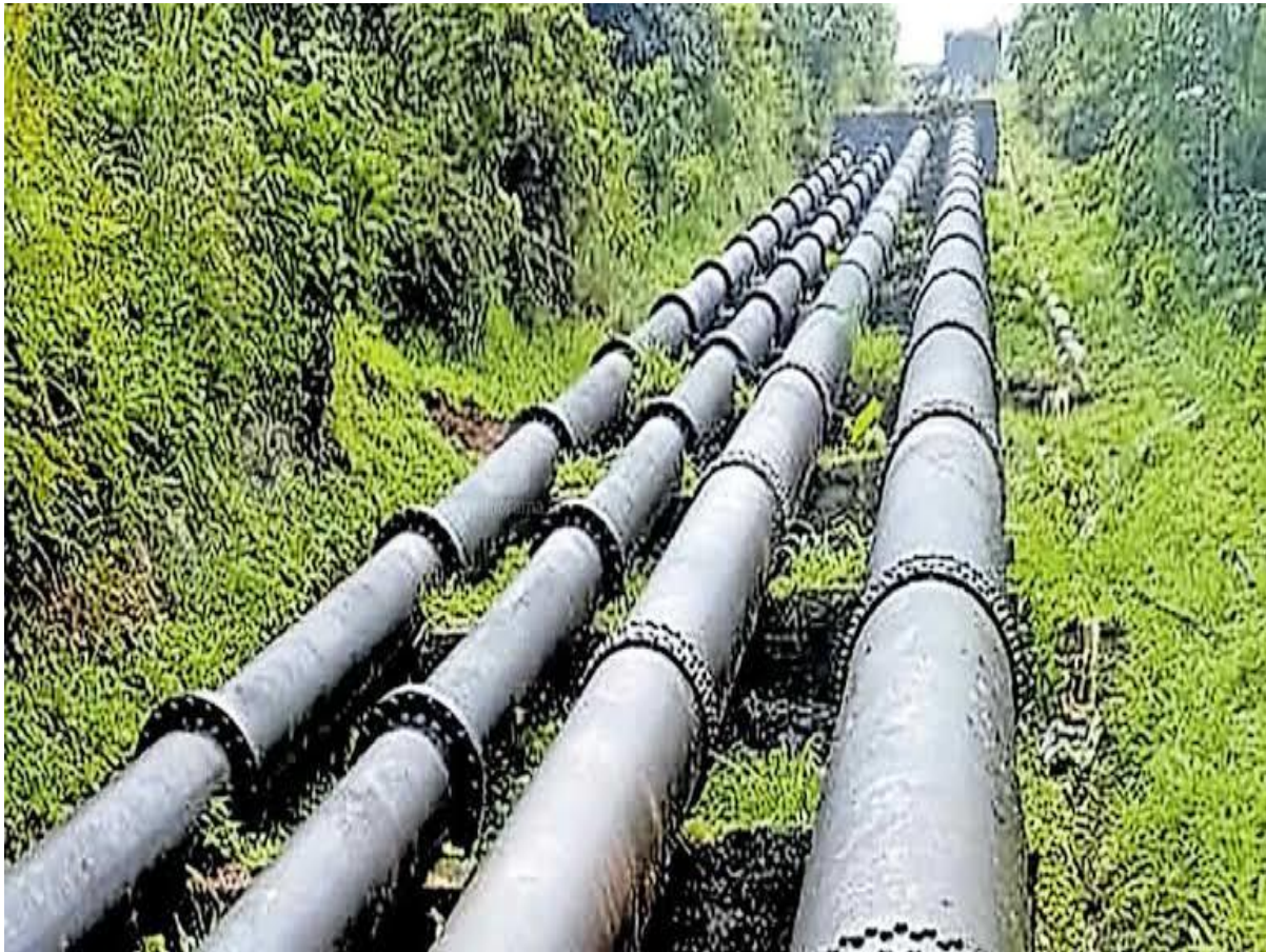
انځور: فشاري نل (Penstock)
