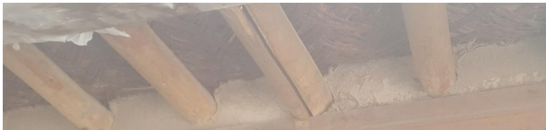
عکس از سقف پیک اتاق بدون مسطح
