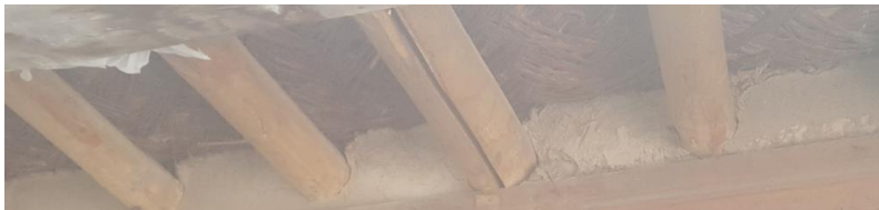
عکس از سقف پیک اتاق بدون مسطح
