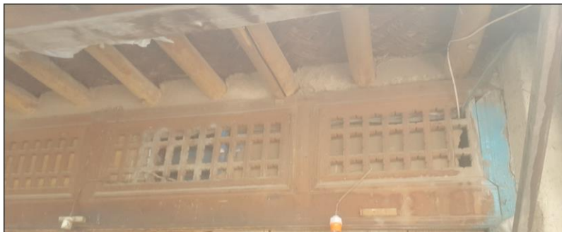
عکس از سقف پیک اتاق بدون مسطح
