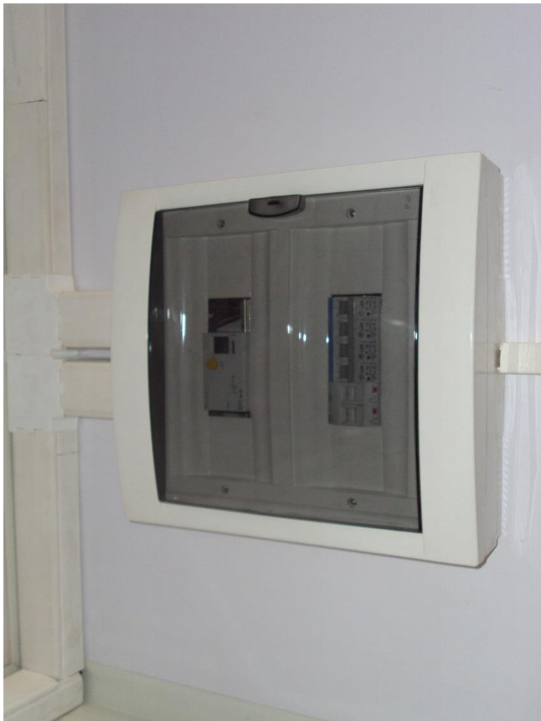
تصویر نصب فیوز بکس در کانتینر های تی آی ام
