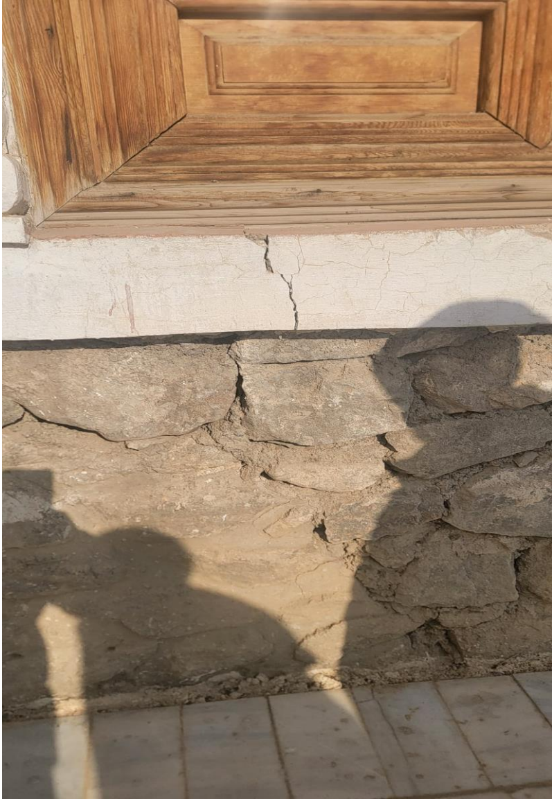
تصویری از ترک (درز) عمودی در ساختمان حرمسرا
