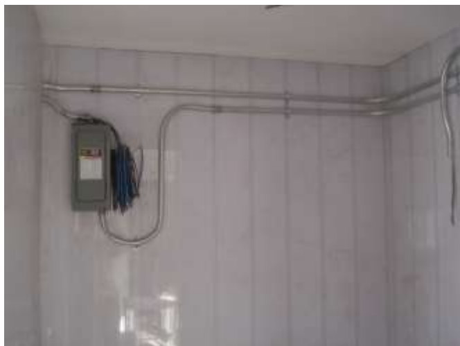
تصویری از سیستم برق تشناب کانتینر
