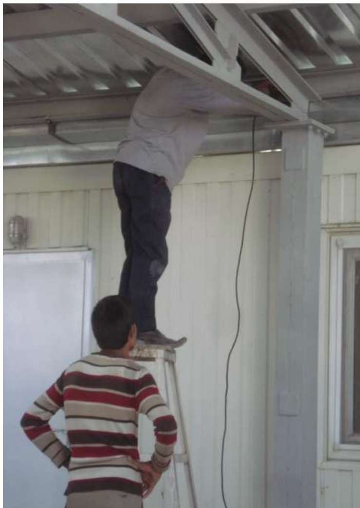
تصویری از اتصال برق هواکش ورکشاپ
