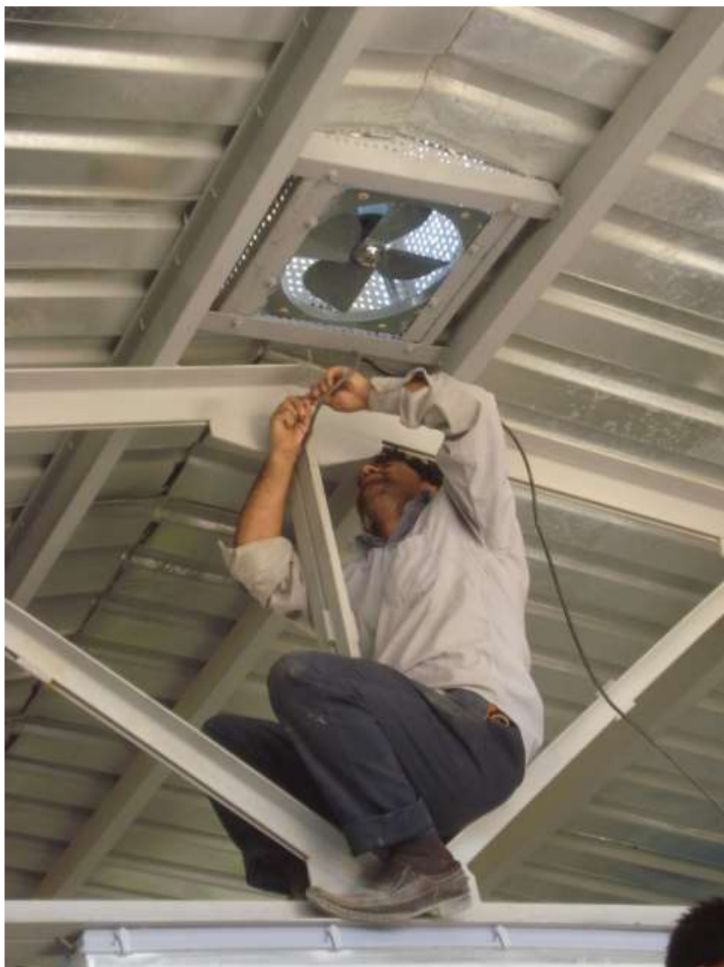
تصویری از اتصال برق هواکش ورکشاپ
