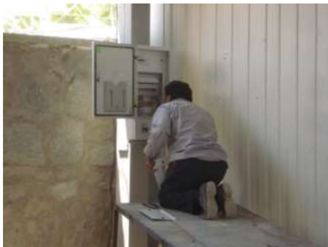
تصویری از اتصال برق ورکشاپ
