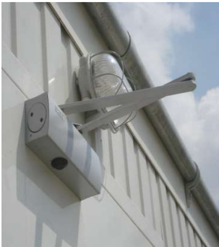
تصویری از قسمت دروازه خارجی (کانتینر)
