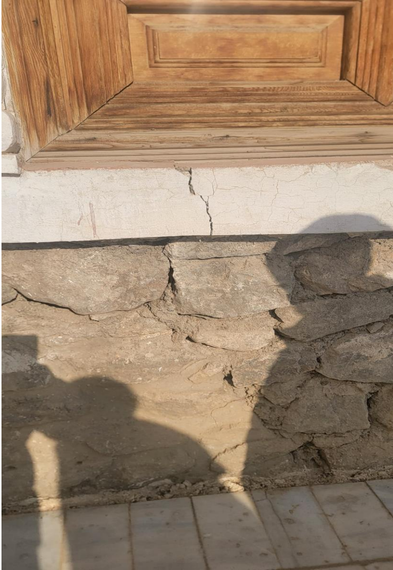
تصویری از ترک عمودی در ساختمان حرمسرا
