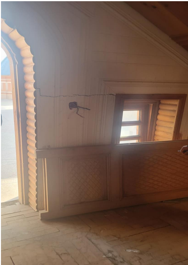
تصویری از ترک (درز) افقی در ساختمان حرمسرا
